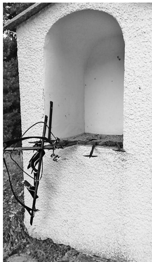
Überbleibsel der gewaltsam aus der Kreuzwegstation gerissenen sakralen Kunstgegenstände.
